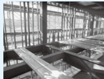
建築中の鹿児島教習所。 作業主任者の指揮の下で 安全作業が行われた。
